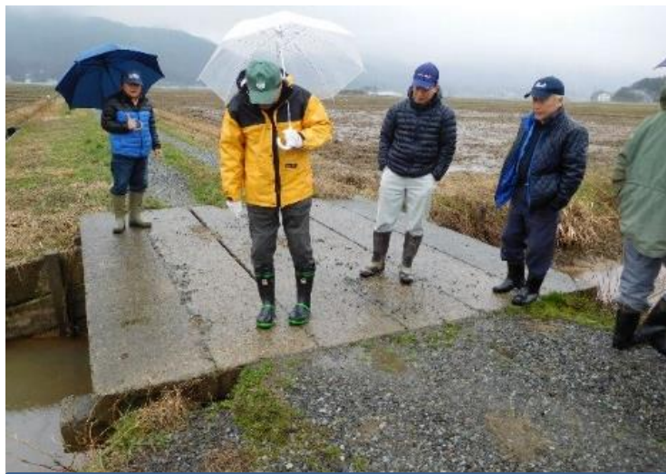
農道の陥没 点検・診断
