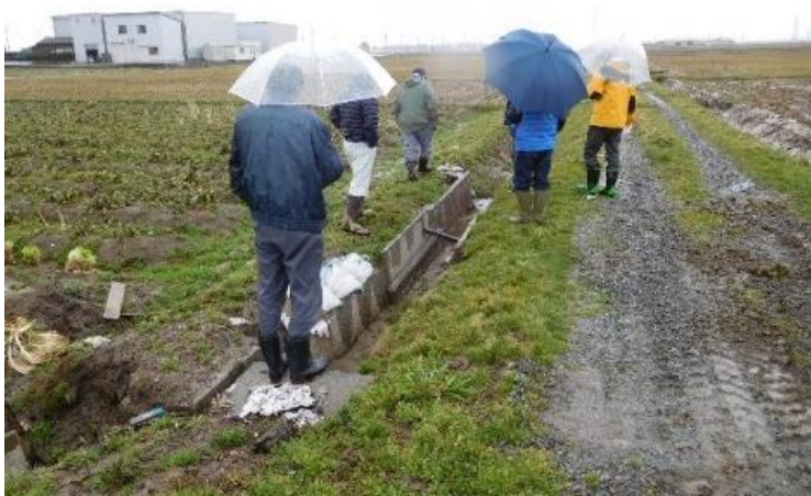
水路の目地開き 点検・診断
