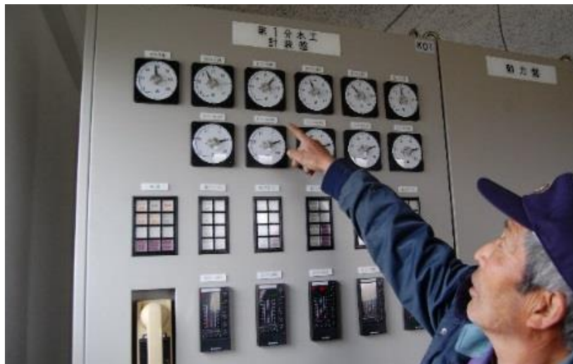
ポンプ場のメーター始動確認
