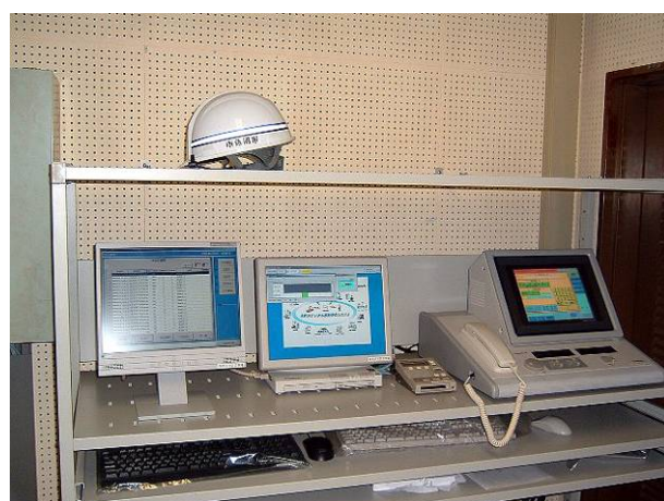
防災無線（統制台）
