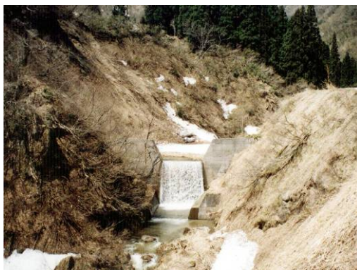
砂防ダム（岩の沢川）
