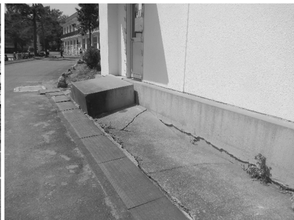
■傾く屋外階段と地盤沈下（北辰小学校）
