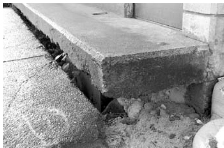
■地盤沈下被害の様子（南魚沼市役所本庁舎）
