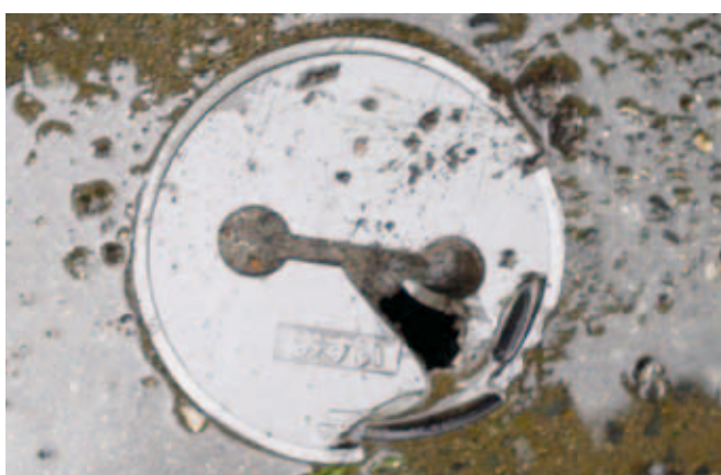
破損した汚水升のフタ
