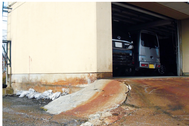
「地盤沈下の影響(市役所本庁舎)」
