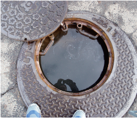
管が詰まって汚水があふれそうなマンホール
