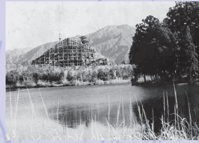
写真1 建設中の六日町ユースホステル（昭和38年11月20日撮影個人所蔵写真）
