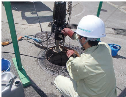
ポンプに詰まったタオルを取除く作業
