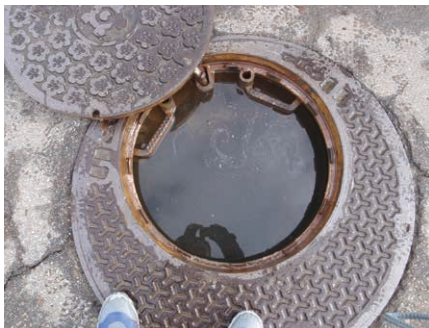
管が詰まって汚水があふれそうなマンホール
