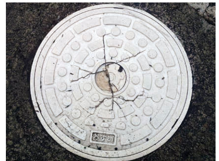
ひび割れて交換が必要なマス
