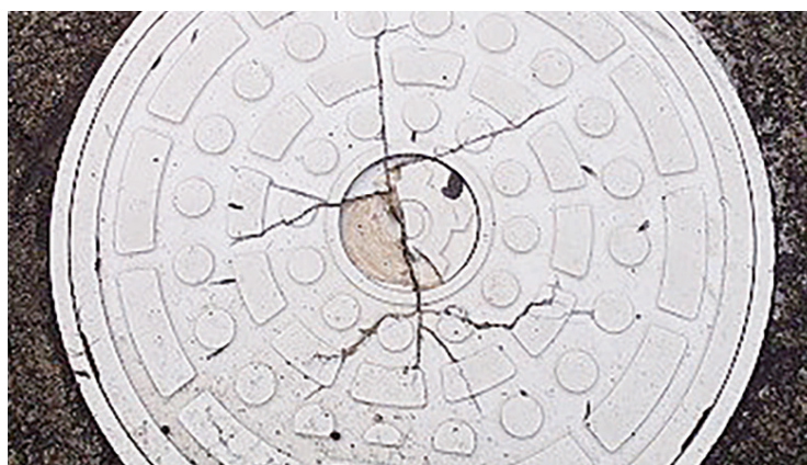
ひび割れて交換が必要な公共マス
