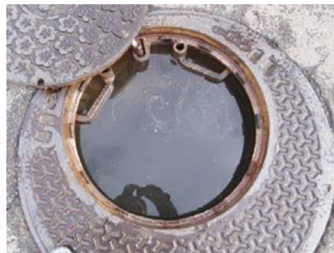
管が詰まって汚水があふれそうなマンホール
