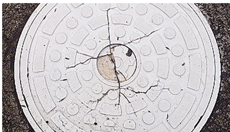
ひび割れて交換が必要な公共マス
