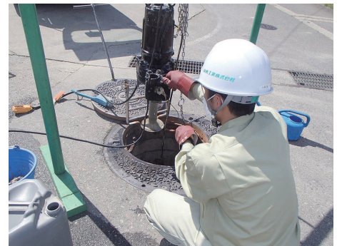
ポンプに詰まったタオルを取除く作業
