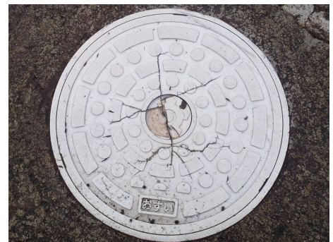
ひび割れて交換が必要な公共マス
