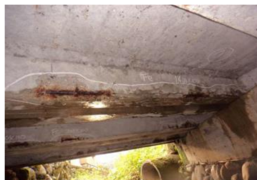
コンクリート橋の剥離・鉄筋露出等
