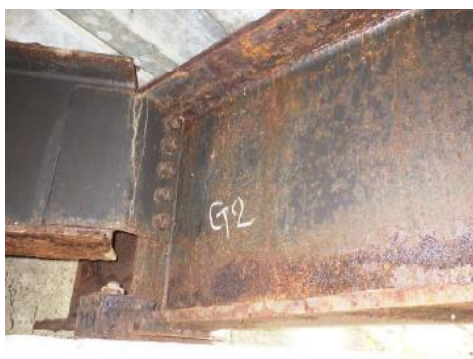
鋼桁の腐食等
