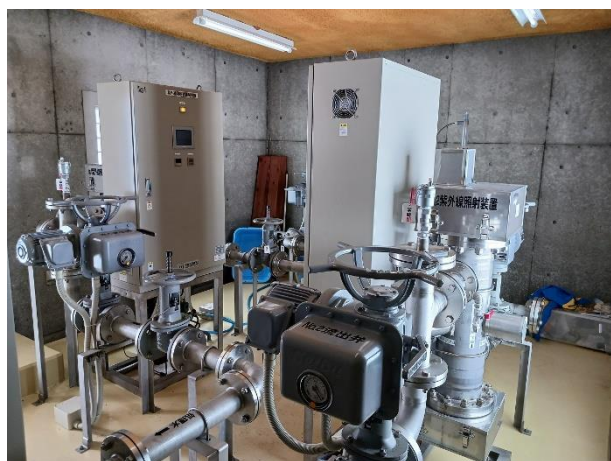
(後山配水池紫外線装置)
