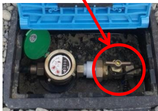
メータボックス内の止水栓の例
