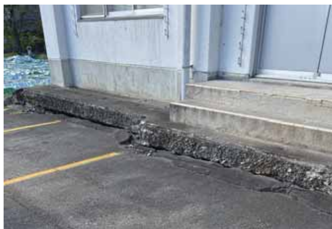
市役所本庁舎の地盤沈下の状況
