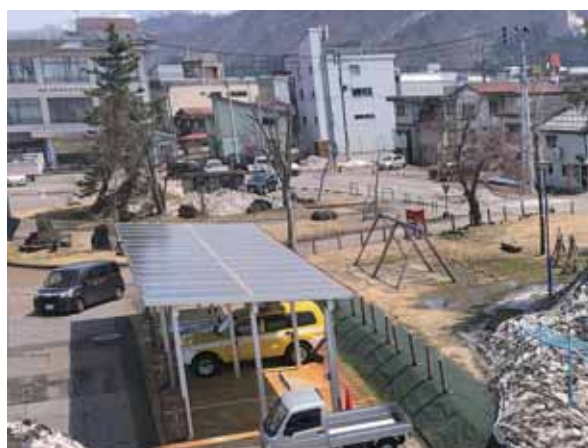
市役所本庁舎の太陽光発電設備
