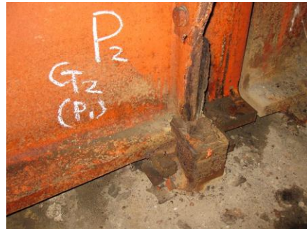
鋼部材の腐食等
