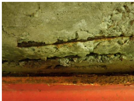
コンクリート床版の剥離・鉄筋露出等
