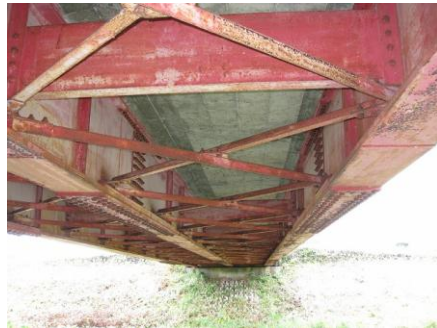
鋼桁の腐食等
