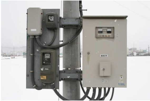
写真 3-1(1) 消雪井戸制御盤
