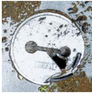
破損した汚水ます
