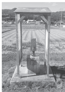
塩沢中学校に設置した防災用井戸
