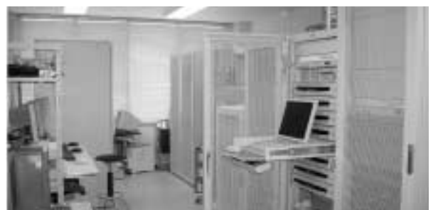
市役所電算室
