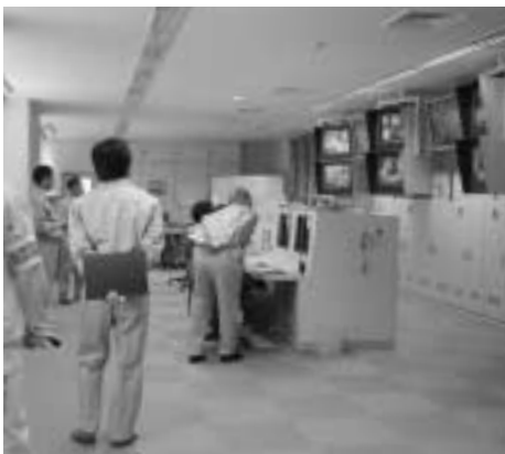
環境衛生センター中央制御室
