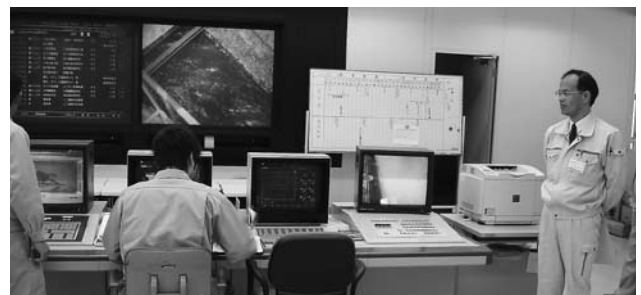
畔地浄水場中央管理室
