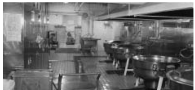
老朽化が進む塩沢中学校給食調理室
