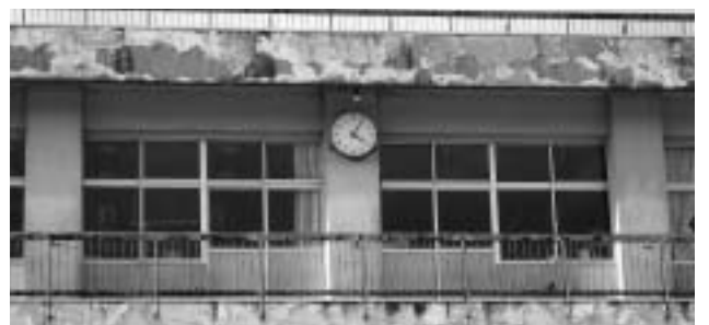
大崎小学校 塗装の剥離
