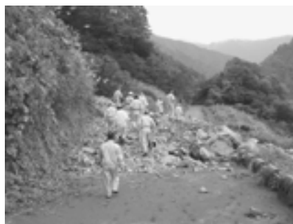
三国川ダム災害現場
