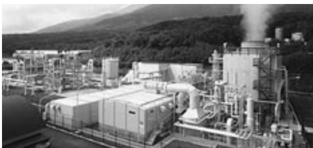
東京電力八丈島地熱発電所
