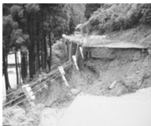
市道永松キャンプ場線 道路崩落
