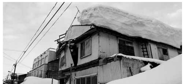
危険な空き家
