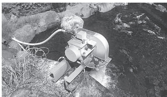
魚沼市 駒の湯山荘の小水力発電施設
