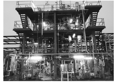
常温、常圧の水素化工システム実証プラント
