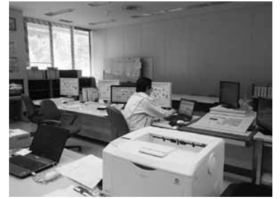
浄水場中央制御室
