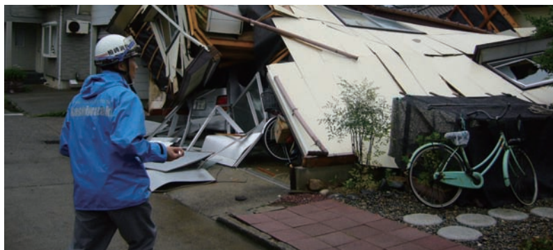
▲ 中越沖地震（柏崎市被害写真）
