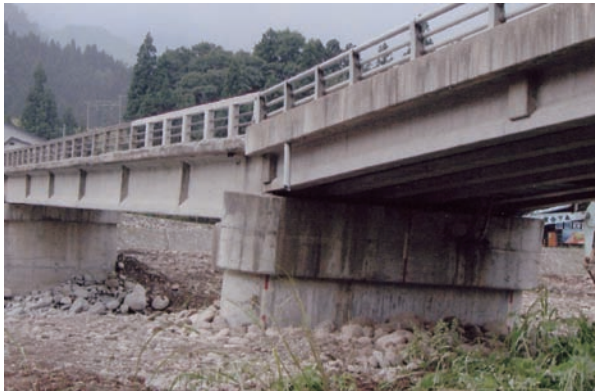
▲ 8月22日台風11号により増水、松川橋脚沈下
