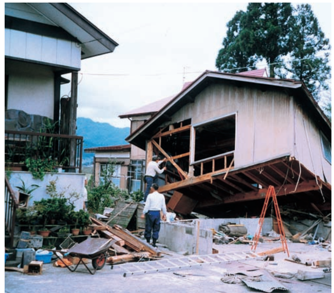
▲台風10号により被害を受けた災害現場
