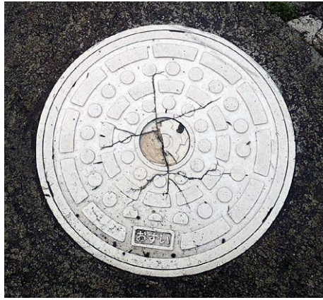
ひび割れて交換が必要な排水マス
