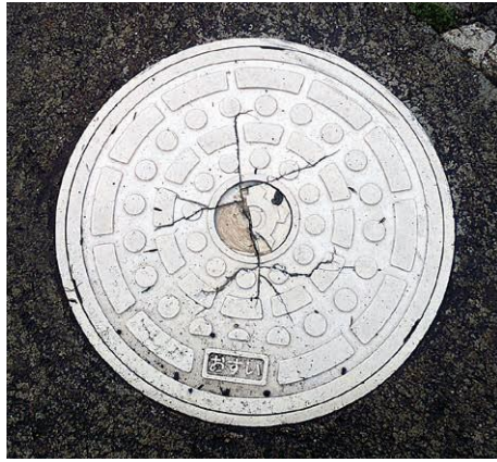
ひび割れて交換が必要な排水マス
