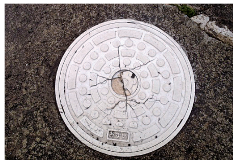
ひび割れて交換が必要な公共マス
