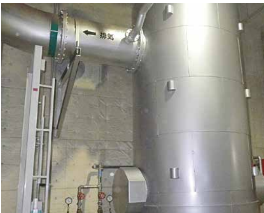
可燃ごみ処理施設内機械装置
