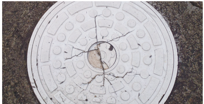
ひび割れて交換が必要な公共マス
