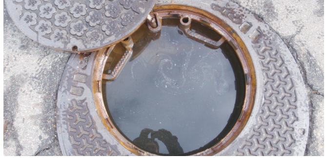
管が詰まって污水があふれそうなマンホール
