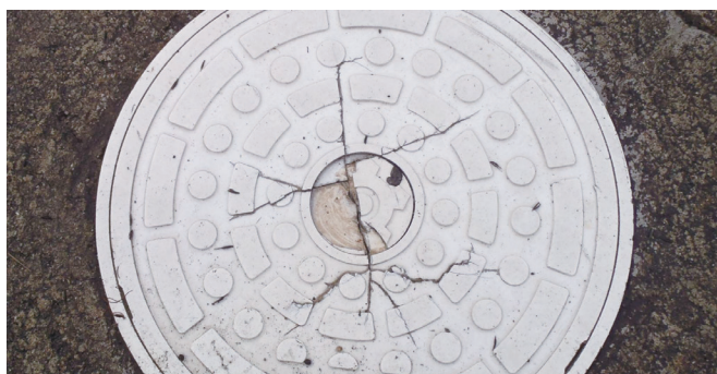
ひび割れて交換が必要な公共マス
