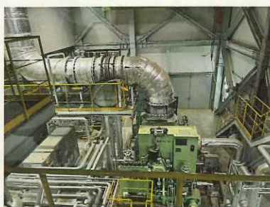
蒸気タービン発電機
