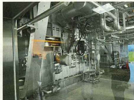
写真右：焼却炉…高温環境下での耐久性から水冷火格子を採用
