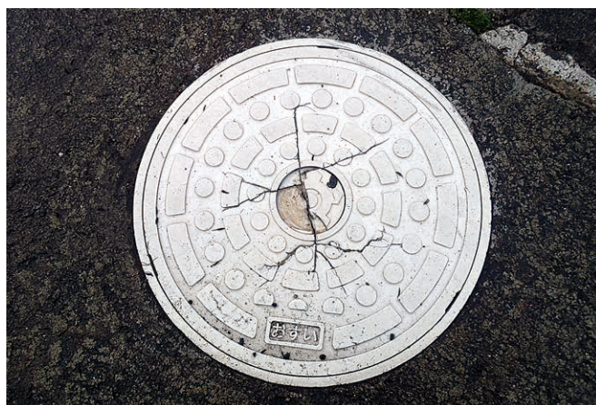
ひび割れて交換が必要な污水マスのふた
