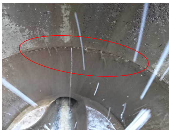
【組立式公共柵からの浸水状況】
