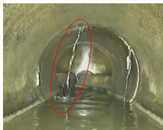
【管渠からの浸水状況】
