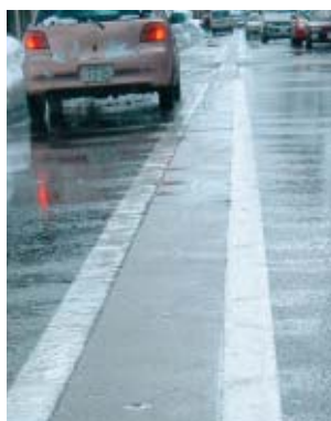
消雪パイプ Pipes to Clear Snow
