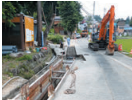
下水道整備の様子 (整備が完了した地区より順次供用開始中)
