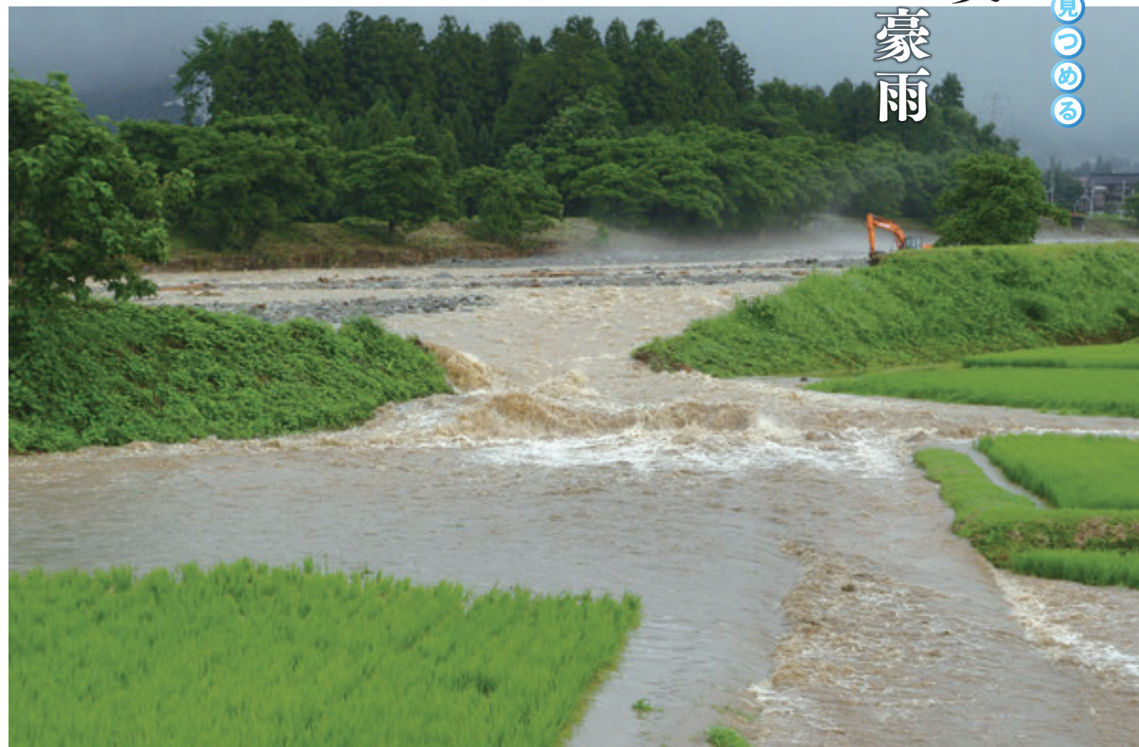
登川の破堤状況(大里地区)
