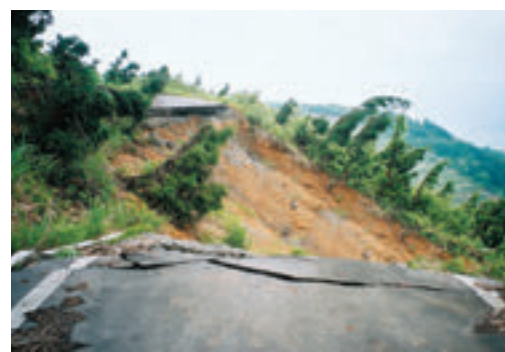
林道浅沢線の崩落状況(四十日地区)
